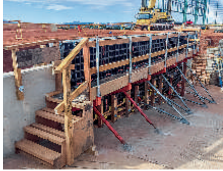
듀오 브라켓과 안전난간 지지대를 보조 목재 구조물과 같이 사용, 안전한 작업공간과 통로를 구축하였다.
