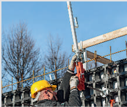
브레이스 커넥터 듀오를 듀오 난간 거치대 (Guardrail Post Holder DUO), 안전 난간대와 조립하여 반대면 안전난간을 설치한다.
